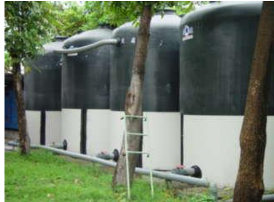
廢水處理設施
