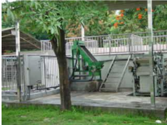
廢水處理設施
